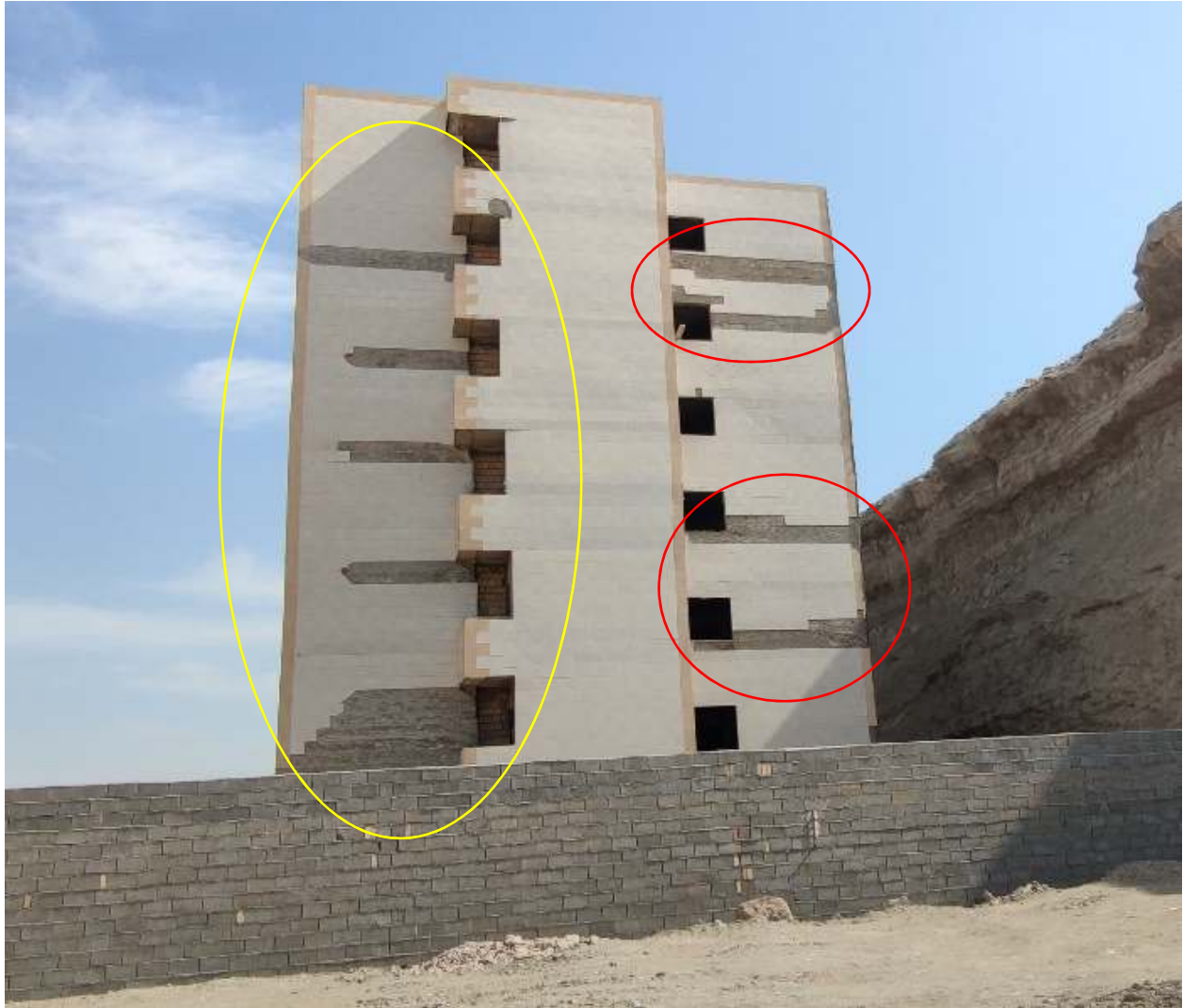
تصویر ۶۳ ریزش نما در ساختمان اسکلت بتنی قبل از بهره‌برداری در بندرعباس
