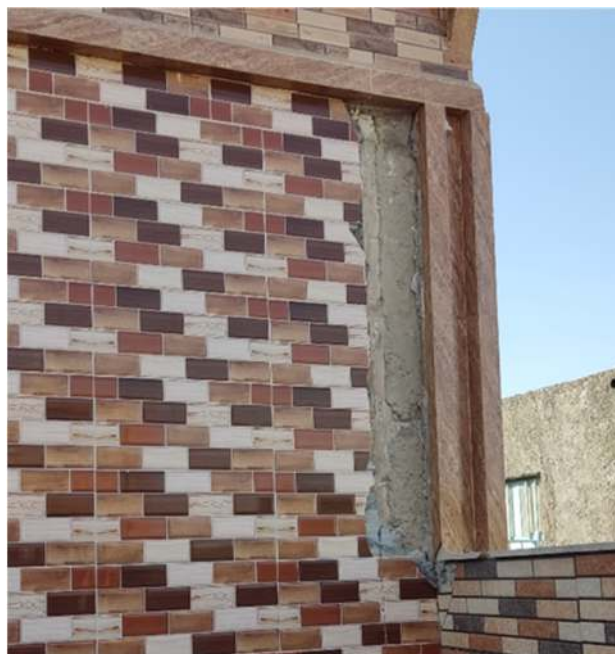
تصویر ۵۷ ریزش نمای سرامیک به دلیل عدم اتصال مناسب نما به سازه در روستای سرزه
