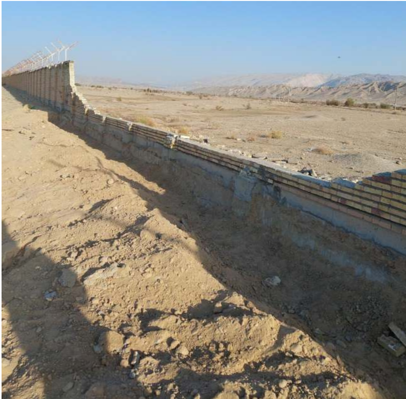
تصویر ۷۱ اجرای یکپارچه دیوار، بدون در نظر گرفتن کلاف‌های قائم و درز بین دیوارها در فواصل مناسب (بخش فین)
