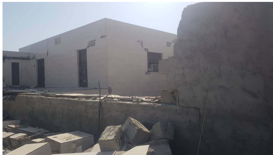
تصویر ۶۶ ریزش نما و دیوارها در روستای گیشان غربی
