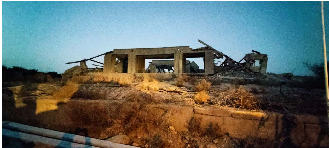
تصویر ۳۲ ریزش سقف و دیوار مدرسه ساخته شده بدون کلاف پس از زلزله ۱۳۵۶ در روستای گیشان غربی
