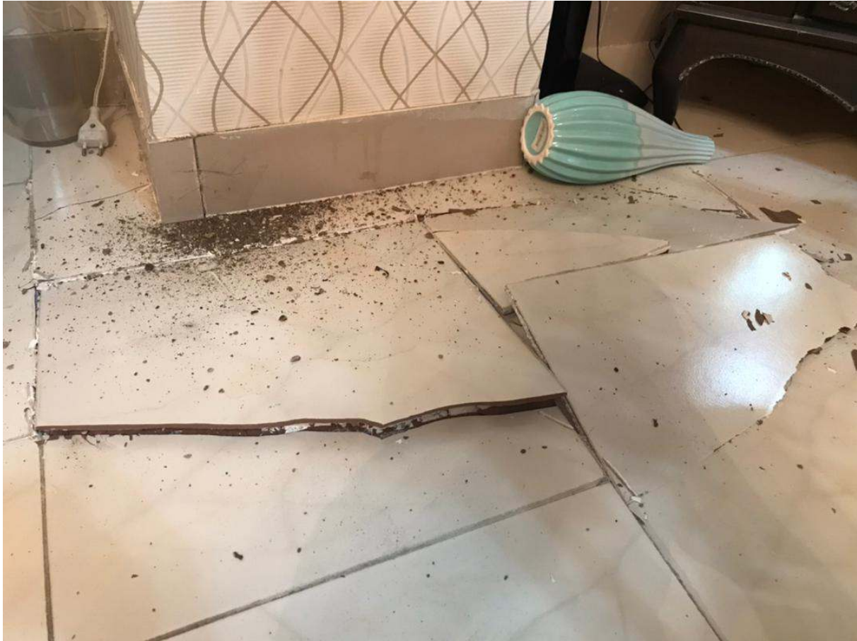
تصویر ۴۸ خرابی پای ستون در ساختمان بتنی ۹ طبقه در شهر بندرعباس
