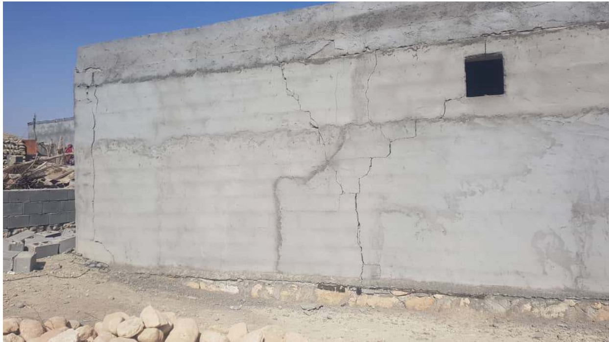
تصویر ۱۶ ترک‌های قطری و قائم در دیوار فاقد کلاف در روستای مزرا
