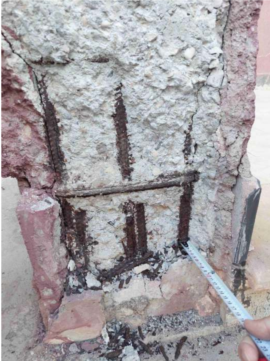
تصویر ۵۳ پدیده خوردگی آرماتور در ستون و تخریب بتن ناحیه پوشش بتن در هنگام زلزله (بخش فین)
