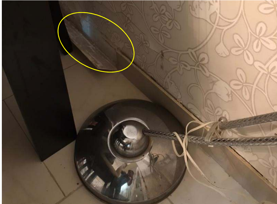
تصویر ۸۳ جداشدگی سنگ قرنیز در ساختمان بتنی ۹ طبقه در شهر بندرعباس به دلیل عدم اتصال مناسب
