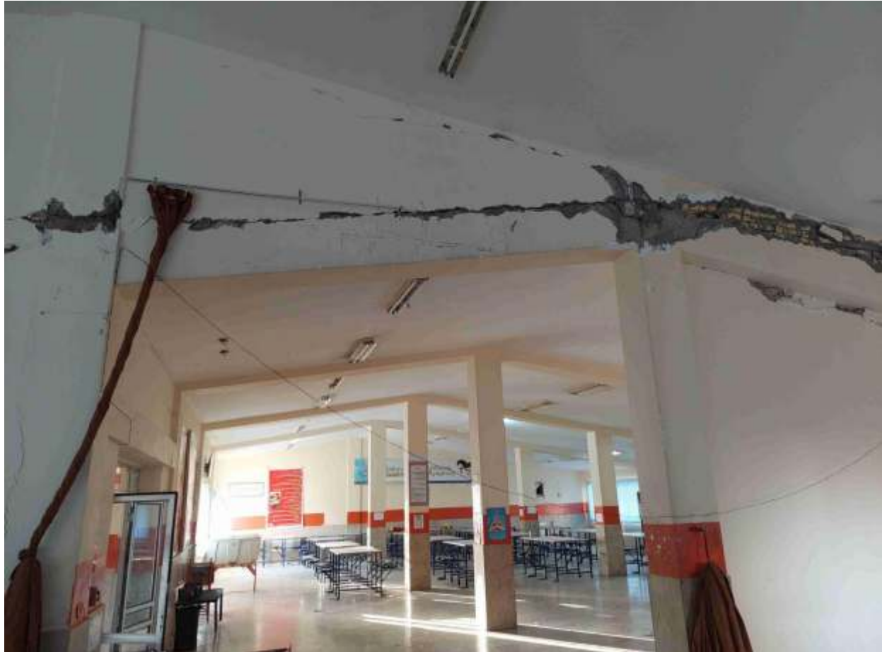
تصویر ۴۶ وجود اختلاف ارتفاع در ساختمان و تشکیل ستون کوتاه (بخش فین)
