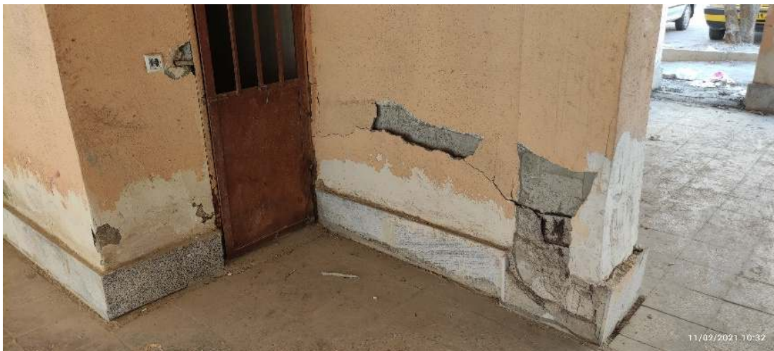
تصویر ۵۵ خوردگی ستون‌های بتنی و فونداسیون سازه به دلیل بالا بودن سطح آب زیرزمینی در بندرعباس
