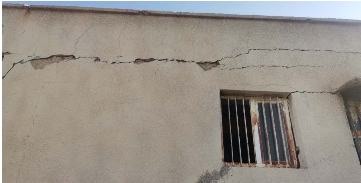
تصویر ۲۳ ایجاد ترک افقی در دیوار بلوک سیمانی روستای قطب آباد
