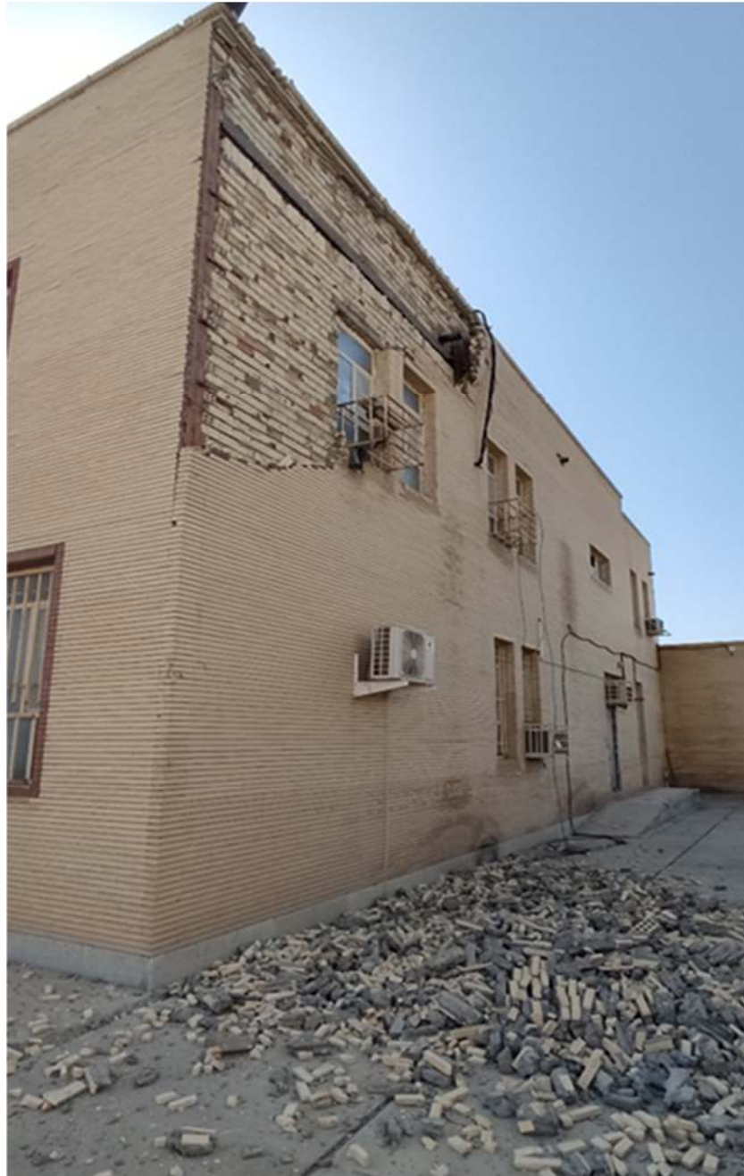
تصویر ۵۸ ریزش نمای پلاک آجری به دلیل عدم اتصال مناسب نما به سازه
