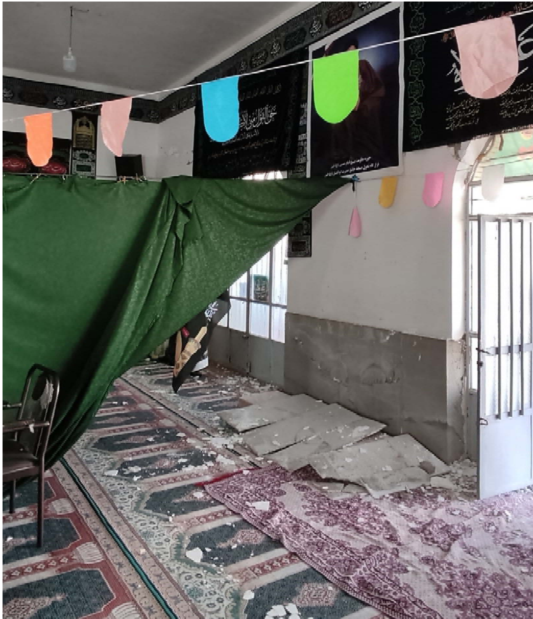
تصویر ۸۹ ریزش سنگ نمای داخلی به دلیل عدم رعایت اسکوپ مناسب در مسجد فین
