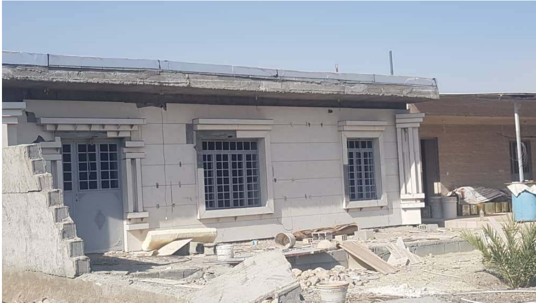
تصویر ۶۷ ریزش نما و دیوارهای محیطی در ساختمان کلاف‌دار در روستای گیشان غربی
