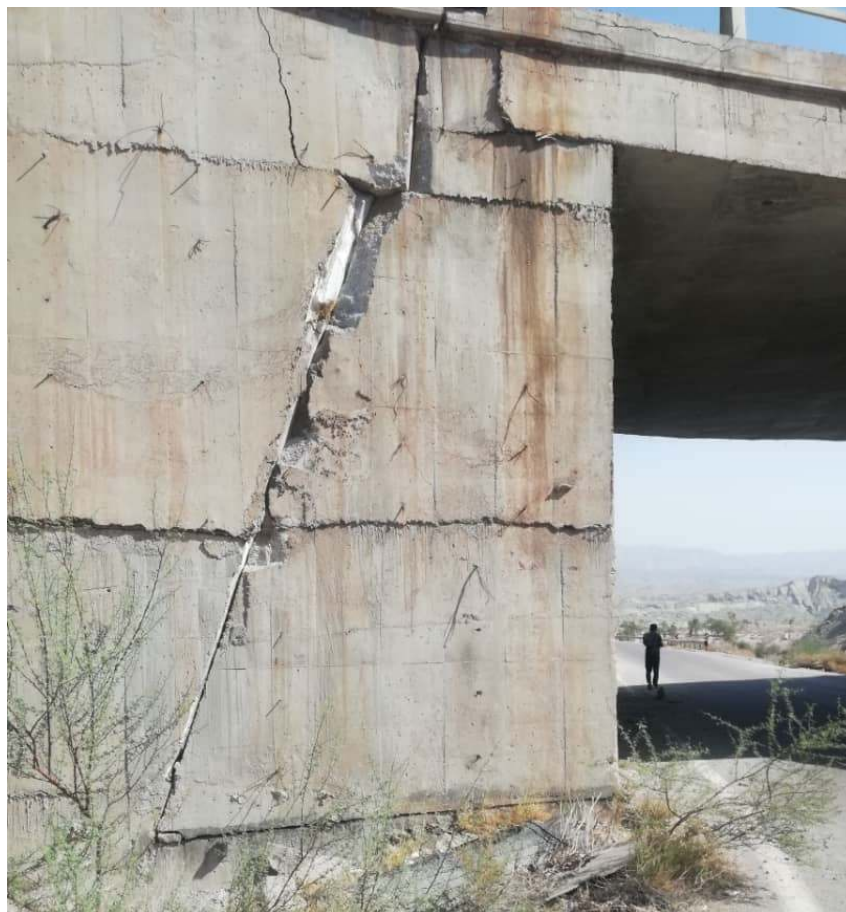
تصویر ۹۹ ترک قائم ایجاد شده در پل نزدیک به روستای گیشان
