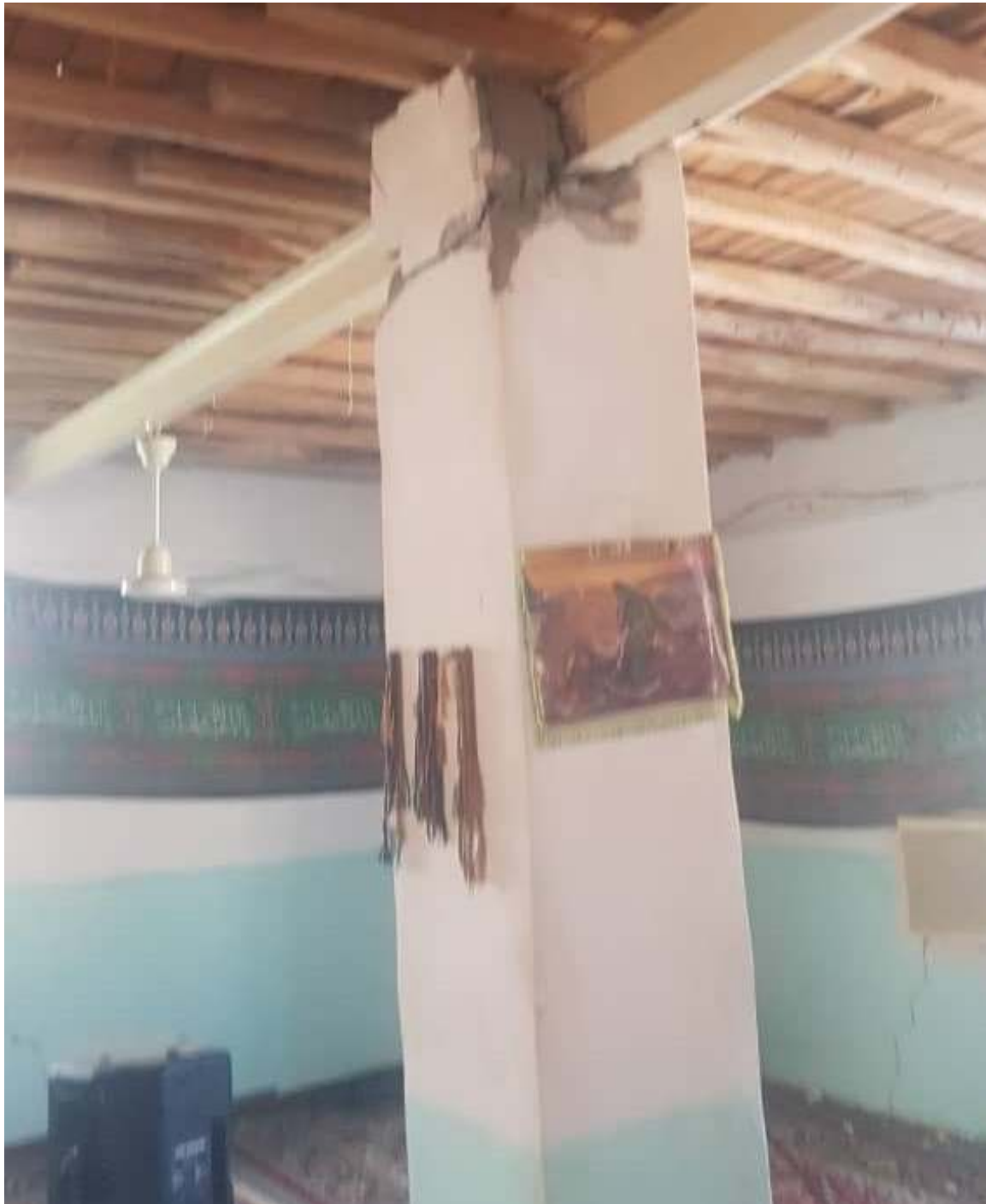
تصویر ۸۸ ترک‌های برشی ستون در مسجد روستای ذرتو
