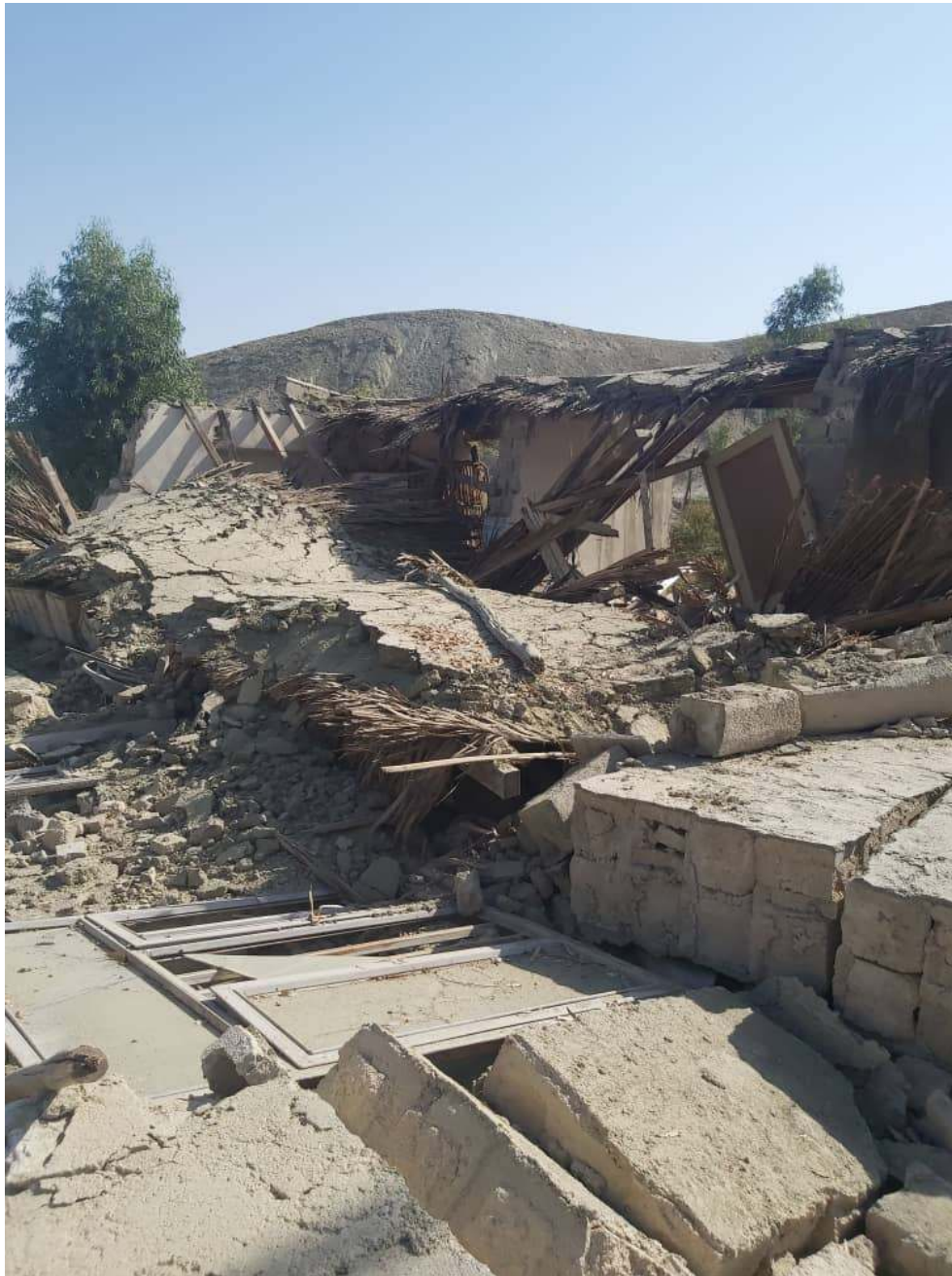
تصویر ۳۰ ریزش سقف اجرا شده با شاخه‌های نخل و گل در روستای مزرا
