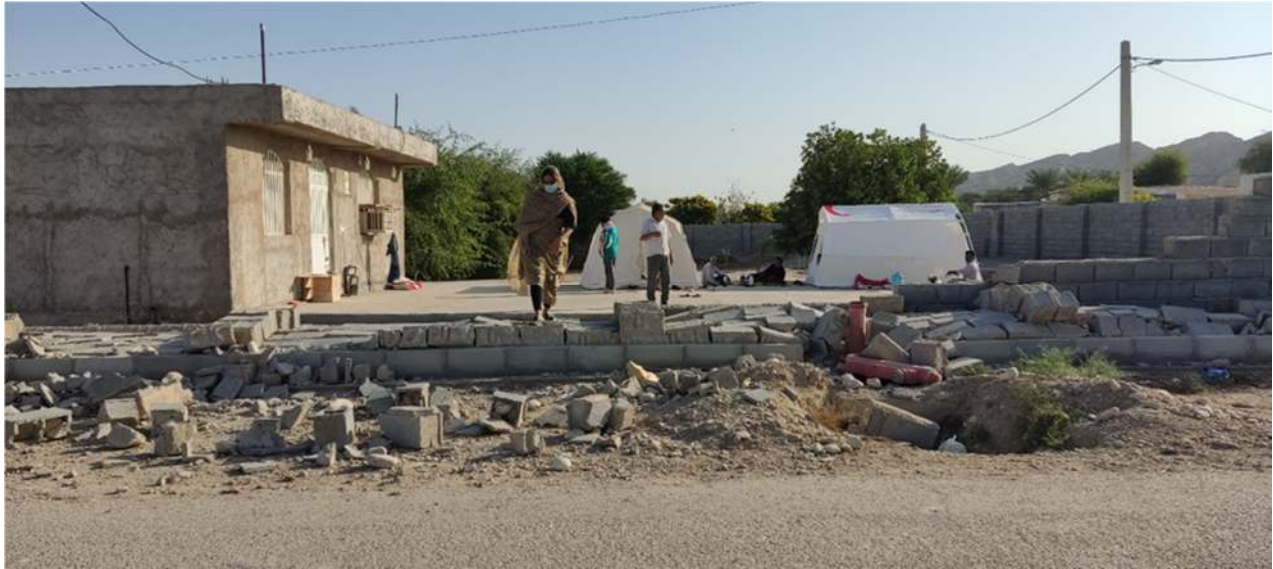
تصویر ۷۴ ریزش دیوار پیرامونی به دلیل عدم استفاده از ملات مناسب و عدم اجرای شناژ و زیرسازی در روستای سرزه
