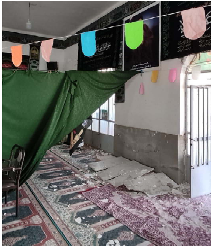
تصویر ۸۱ عدم اسکوپ سنگهای پیرامون دیوار در مسجد فین
