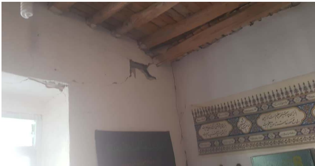
تصویر ۸۶ ترک‌های قطری در دیوار خشتی با سقف چوبی مسجد روستای ذرتو
