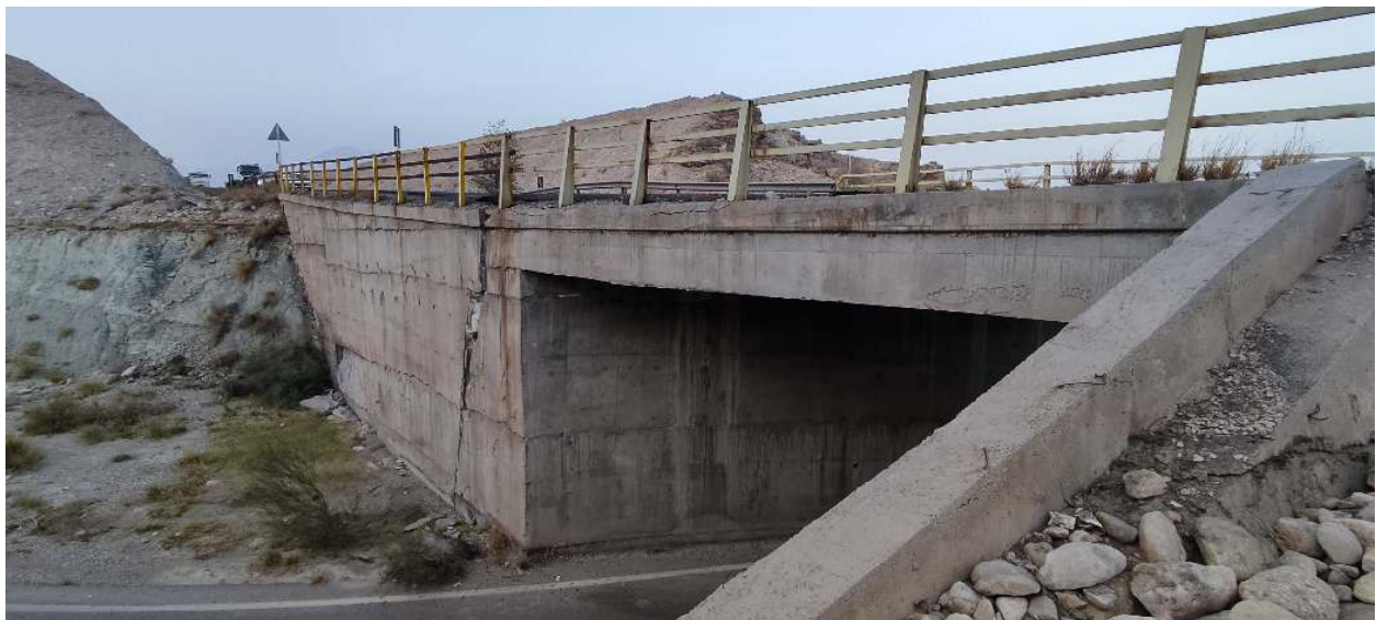
تصویر ۹۷ جابجایی و ایجاد ترک در دیواره پل نرسیده به روستای گیشان غربی
