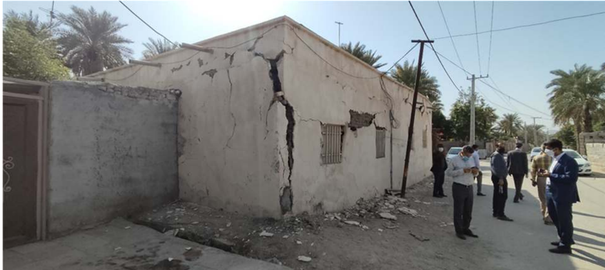
تصویر ۲۱ ترک دیوار خارجی ساختمان خشت و گلی در فین (یک لایه دیوار با ملات سیمان در پشت اجرا شده است)
