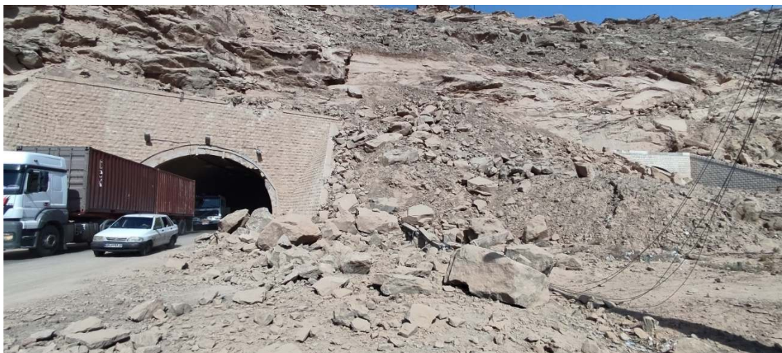
تصویر ۱۰۳ ریزش لایه‌های ناپایدار و مسدود کردن دهانه خروجی تونل شهید میرزایی و خرابی شبکه برق
