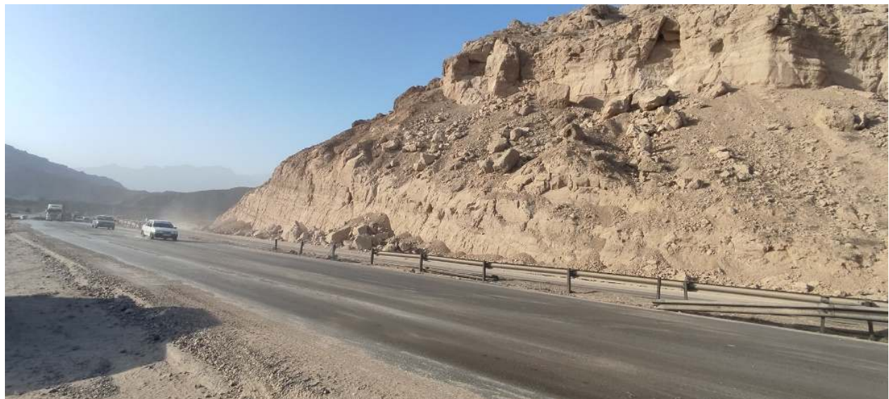
تصویر ۱۰۱ ناپایداری قطعات سنگی شیب مجاور جاده در نزدیکی تونل شهید میرزایی
