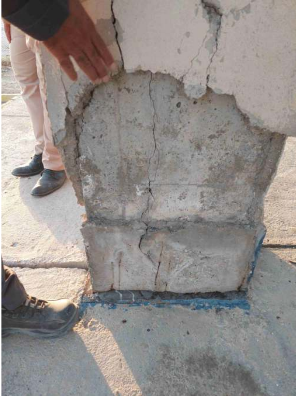
تصویر ۴۷ وجود ترک در پای برخی از ستون‌ها و کاهش ظرفیت باربری ستون (بخش فین)
