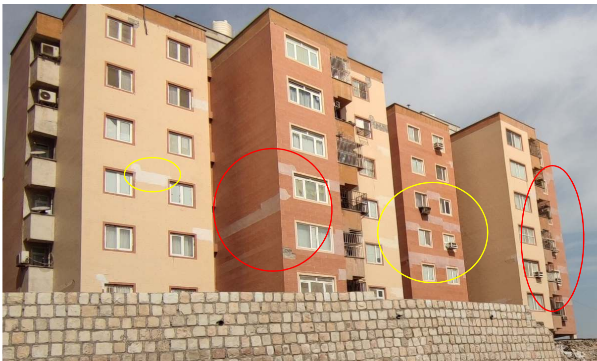
تصویر ۶۰ ریزش نمای سنگ و سرامیک از ارتفاع به دلیل اجرا و اسکوپ نامناسب در بندرعباس
