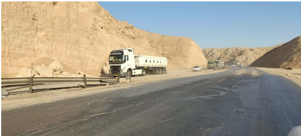
تصویر ۱۰۰ مسدود شدن یک باند جاده بندرعباس - سیرجان بر اثر ریزش قطعات سنگی از شیب مجاور در نزدیکی تونل شهید میرزایی
